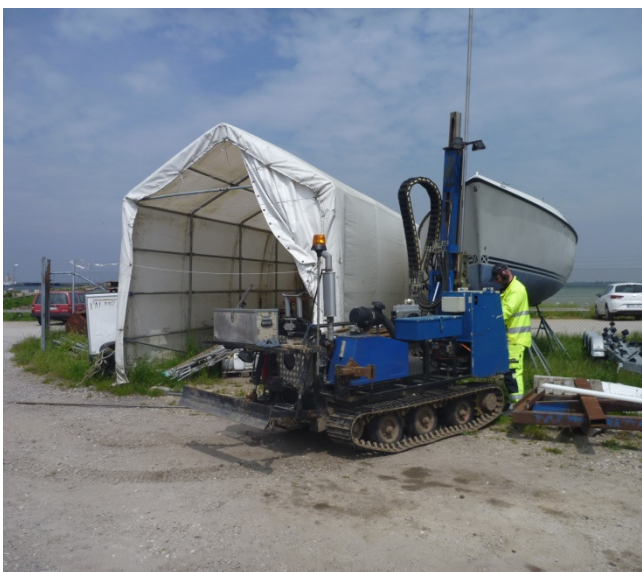
Figur 8. Provtagning av punkt 8 inom marinbutikens område. Föroreningar av PCB och PAH med hög molekylvikt noterades i markytan. I grundvattnet påvisades oljekolväten i en halt över riktvärdet för ångor.
